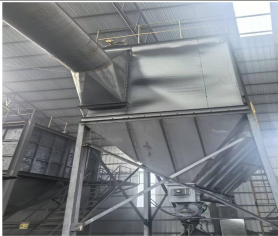
筛分车间除尘器
