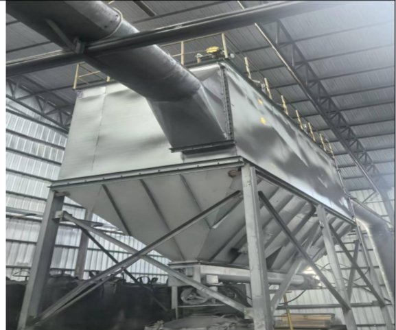
筛分车间除尘器
