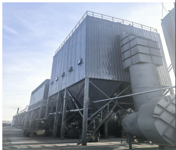
活化炉配套除尘器
