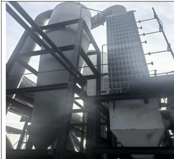
活化炉尾气降温设施
