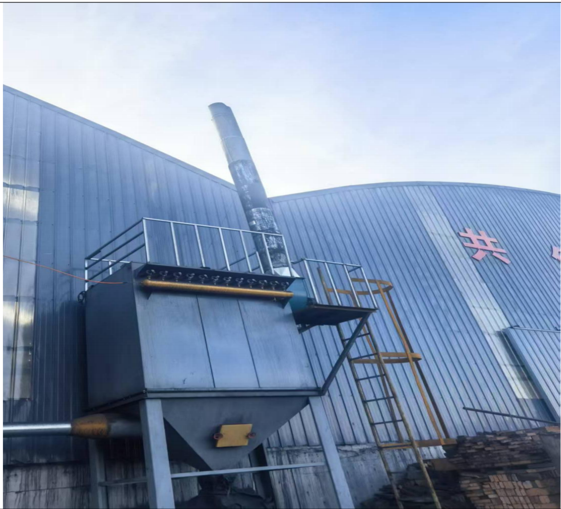
原料车间除尘和排口
