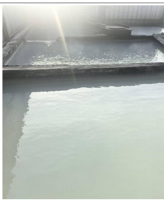
活化炉配套脱硫循环水池
