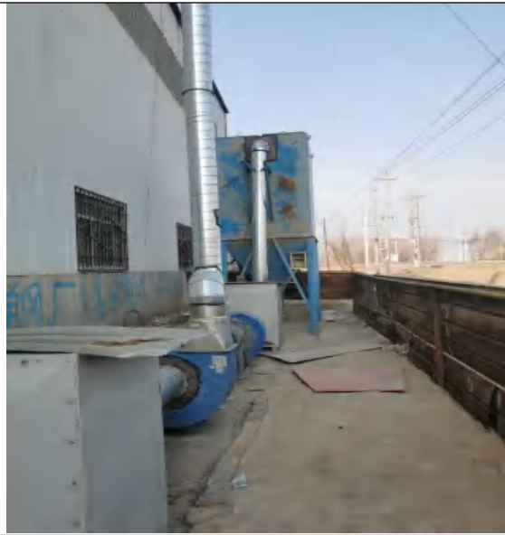
排放口处活性炭和布袋除尘
